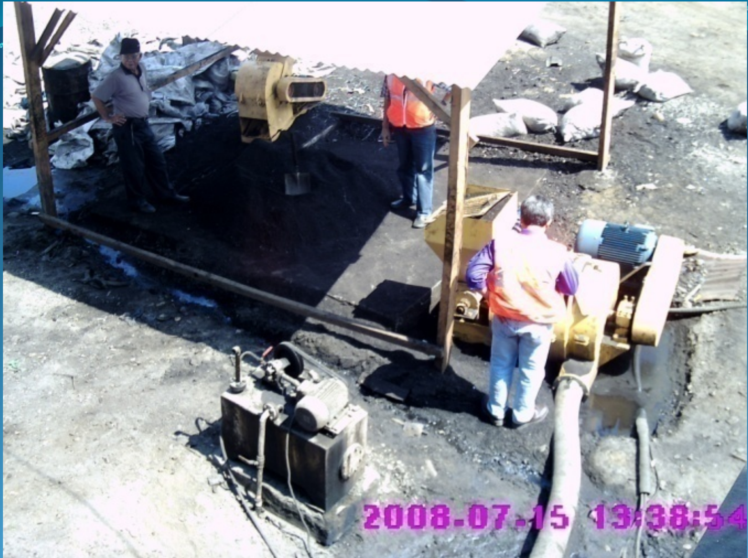
Instalasi unit Pulverizer Batubara yang tidak terintegrasi dan terendam air
